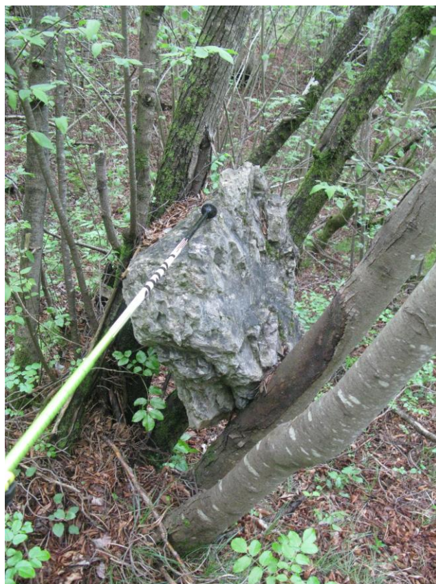
Foto n°10: blocco franato ( V \approx 0.15 \text{ m}^3 ) - (punto n°7).
